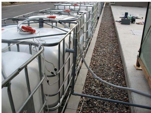
液肥貯蔵タンク
